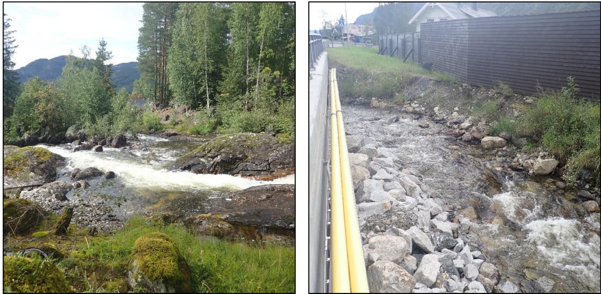
Figur 14: Elvesplitting til venstre (H.1.2) og erosjon mot boligbebyggelse til høyre (H.1.5).
