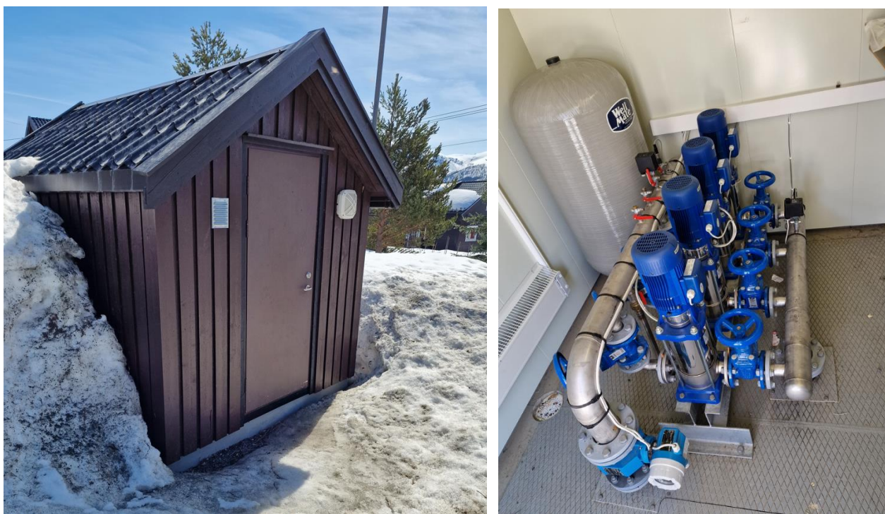
Figur 3: Eksempel på trykkøkningstasjon med overbygg og pumperigg innvendig.
